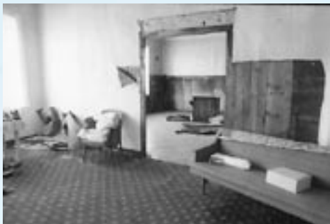
Storsalen m/scene i dag var opprinnelig 3 rom. I 1985 ble 2 vegger revet og lokalet utvidet.
